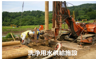
洗浄用水供給施設
