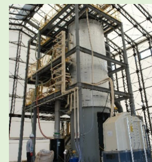
メタン発酵施設
